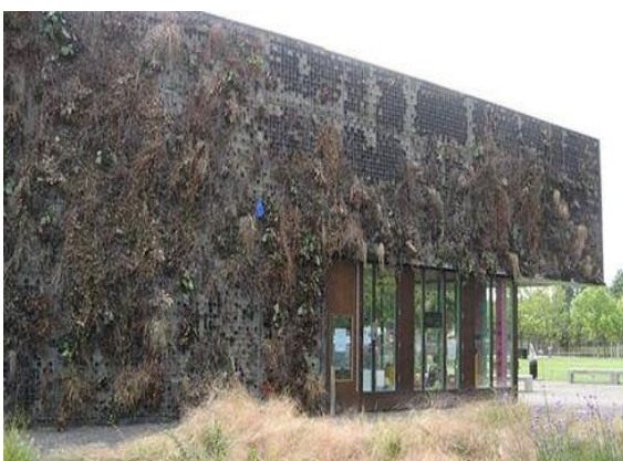
Figura 2.8 - Fachada verde com problemas, Wolmarans (2013)
